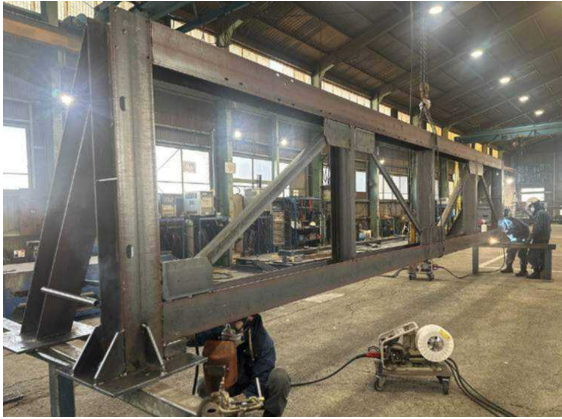
配管サポート架台
